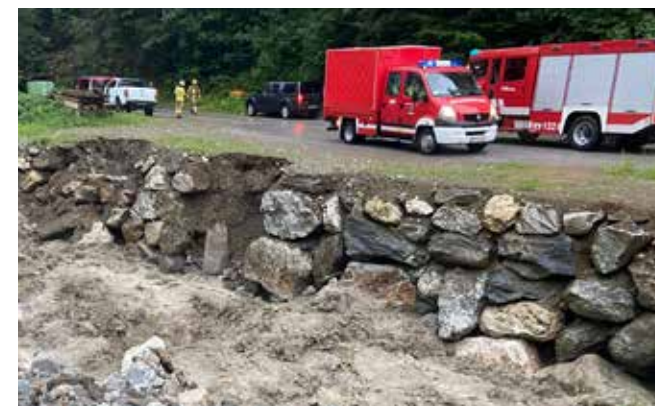
Schäden nach heftigen Unwettern im Bereich Kleinschwendberg und Burgstall.
